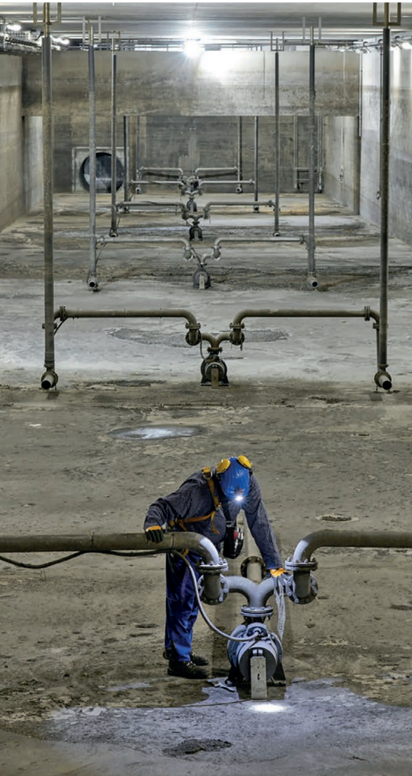
Stauraum unter Hamburg: Unterirdische Rückhaltebecken wie hier unter dem Anckelmannsplatz bieten Platz für die Wassermassen (Foto: Jörg Böthling / HW)
