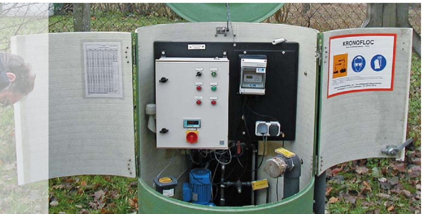
Abbildung 35: Dosieranlage Eisen-II-Chlorid Pumpwerk Kayhude
