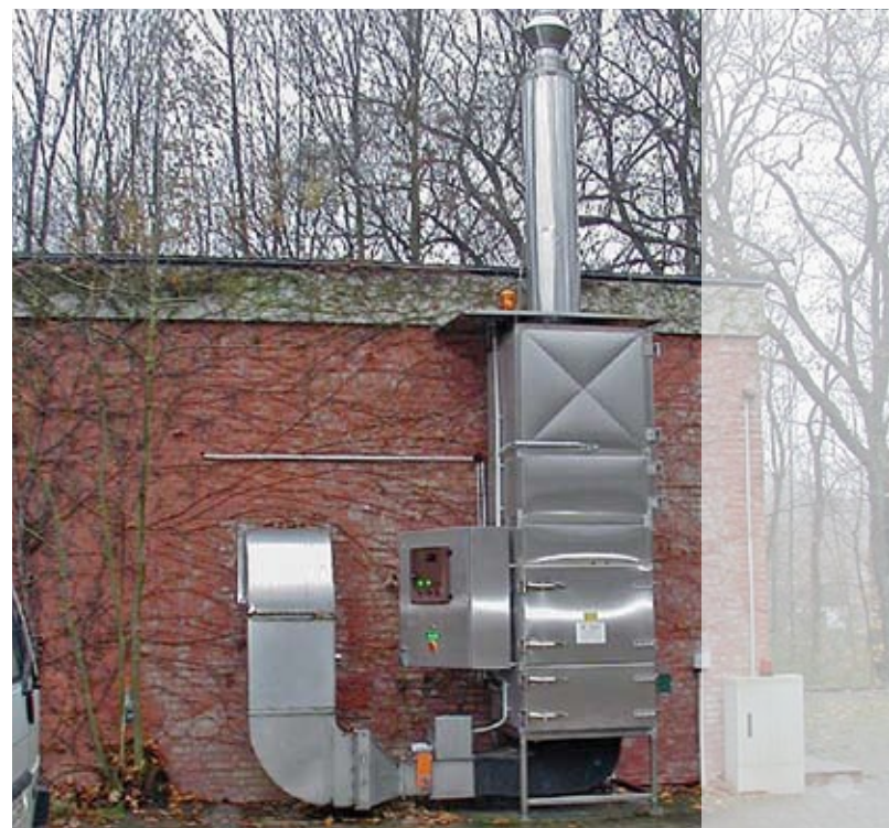
Abbildung 34: Aktivkohlefilter am Pumpwerk Wellingsbüttel
