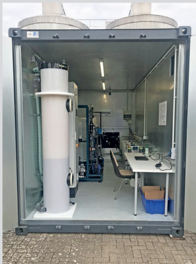
Forschungscontainer auf dem Gelände des Wasserwerks Süderelbmarsch.
