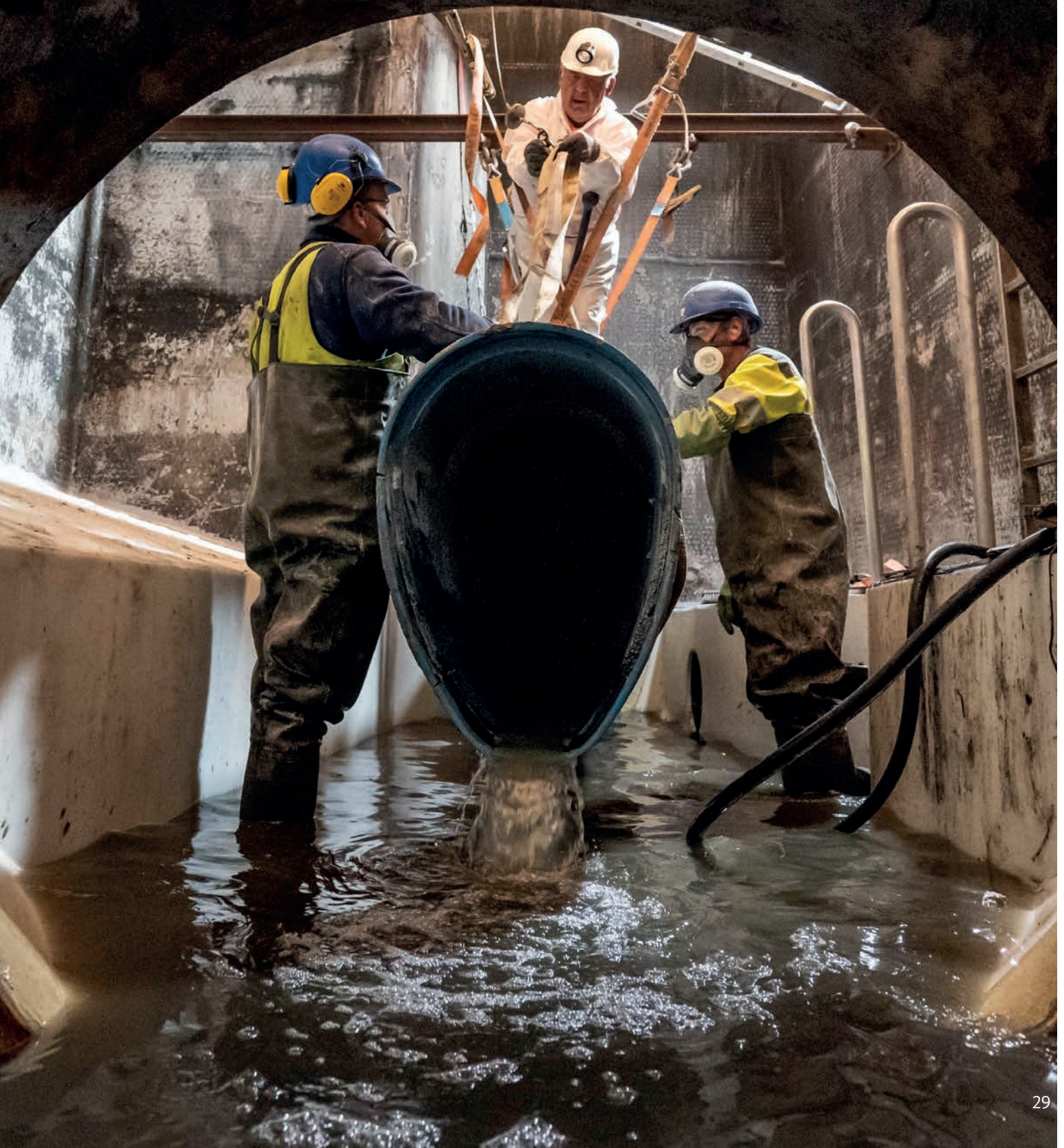
Entfernung der inneren Verrohrung im Transportsiel in Altona. Foto: Kraft Angerer / HW
