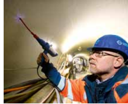
ALLES DICHT? CHRISTOPHER RUDLAFF ÜBERPRÜFT DIE SCHWEISSNÄHTE DES NEUEN TRANSPORTSIELS MITHILFE EINES FUNKENBESENS.
