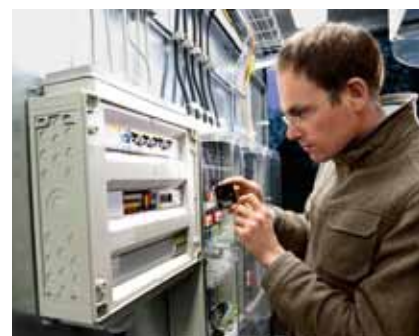
DER BLICK AUF DEN LAUFENDEN ZÄHLER VERRÄT: HIER WIRD STROM FÜR DIE ANWOHNER PRODUZIERT.
