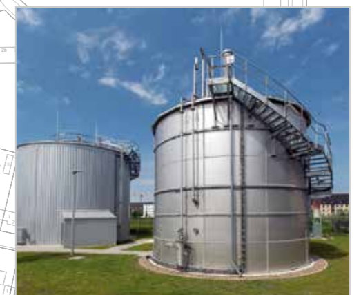
Fermenter (links), Biogasspeicher (rechts)
