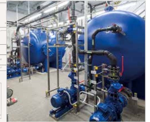
Vakuüm tanks in der Vakuümstation
