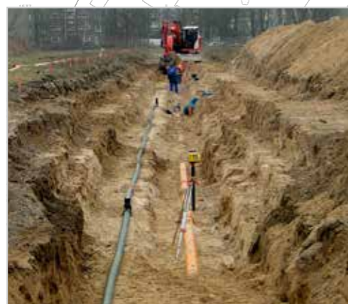
Vakuümleitung für Schwarzwasser (links) und Grauwasserleitung (rechts)
